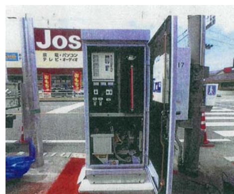
御坊市役所北交差点の装置
